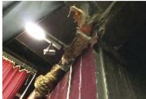
Etat des canalisations - Salle de spectacles
