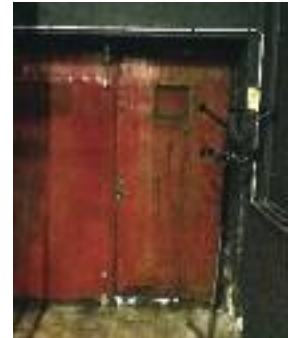
Porte de secours rongée - MJC
