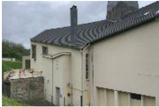
Garde-corps manquant Terrasse Auditorium
