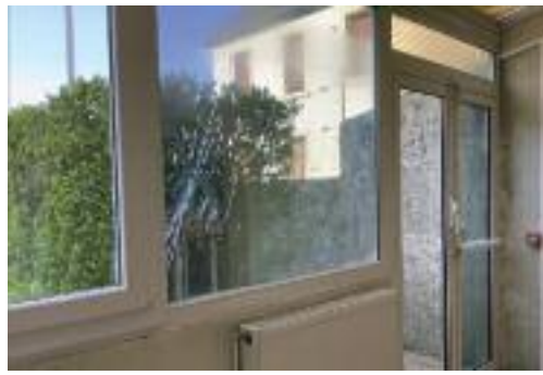
Carreau cassé - Véranda MJC
